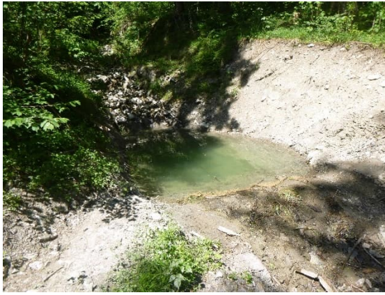
oberhalb Durchlass ca. km 0.800 Lauibach vor Hochwasser (20. Mai 2022)
