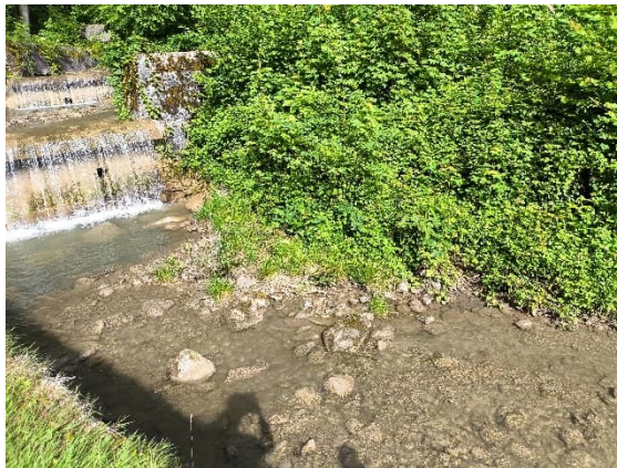
Ablagerungen zwischen Sperre 595 und 597 Felsbach
