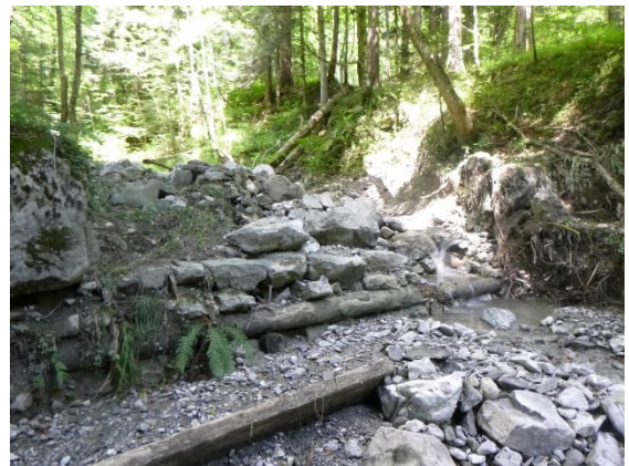
zerstörte Holzsperrre am Läuibach nach Hochwasser
