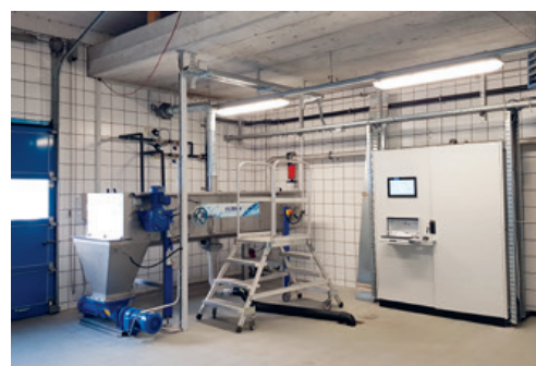
Anlage zur Schlamm- mentwässerung
