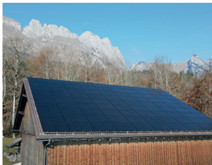
Neue Photovoltaikanlage auf Dach Reservoir Rafinen
